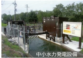
中小水力発電設備
