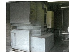
③ 樹脂燃料ボイラー本体
