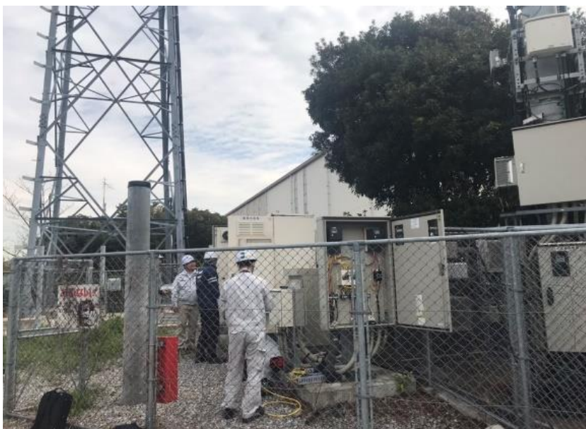
【SB通信基地局の併設蓄電池】
