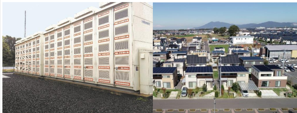
実証参加中の大容量蓄電池(NaS電池)
