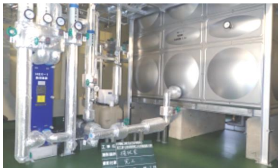
熱源槽と熱交換器
