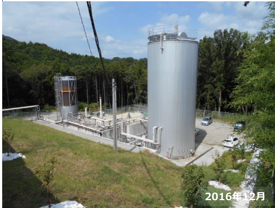
バイオマス燃料製造設備
