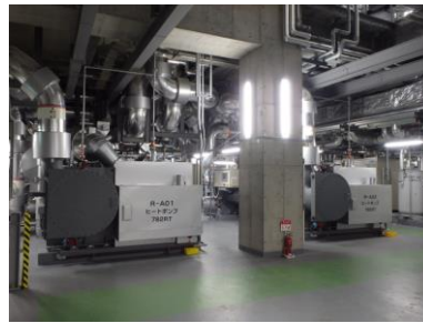
ターボヒートポンプ
