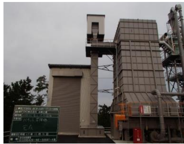
燃料供給装置
