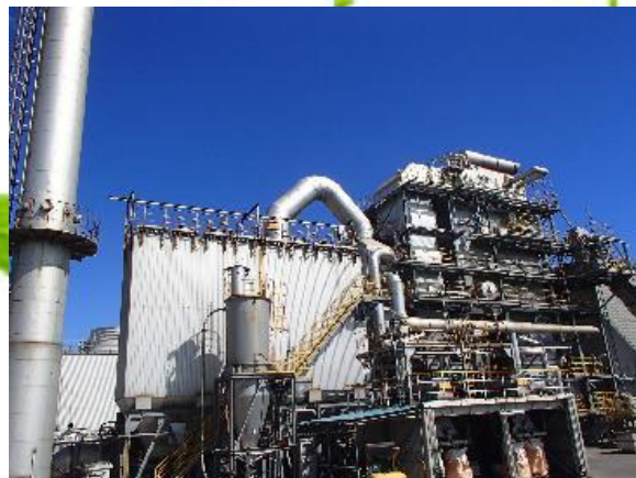
木質チップ燃料によるバイオマスボイラ (蒸気30t/h + 発電4,000kW)
