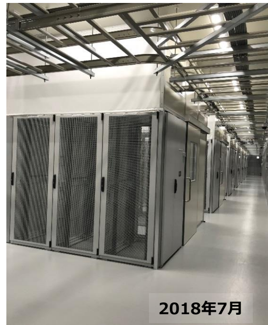
サーバラック
