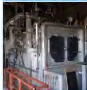
木質バイオマス発電
