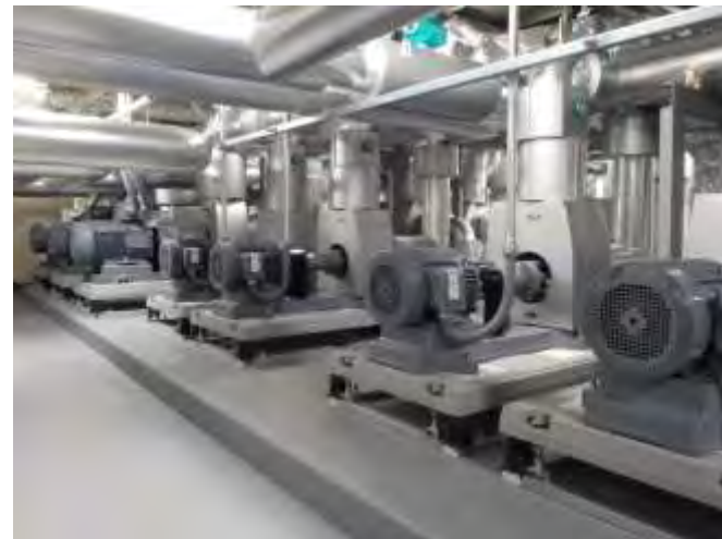
放熱ポンプ（計7台）
