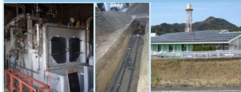
木質バイオマス発電 地中熱利用 太陽光発電
