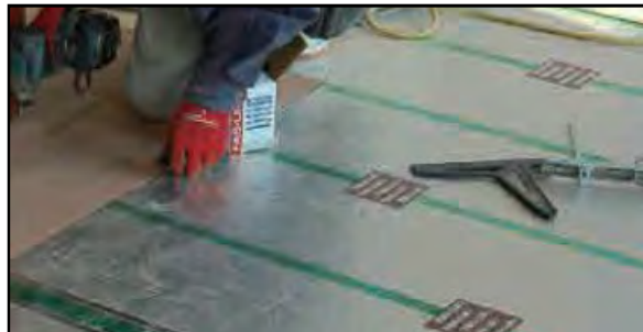
床冷暖房 ／東京ガス株式会社
