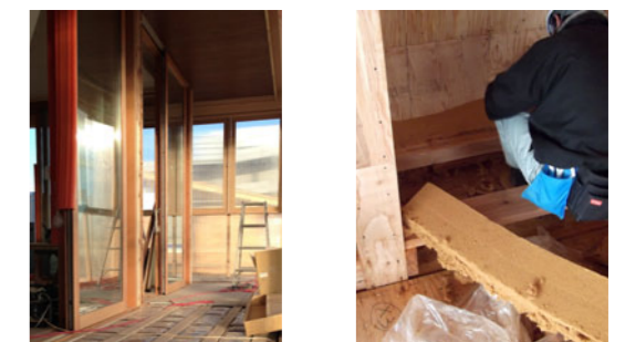
図 1-3 国産材を使用した木製窓（左）と、国産間伐材を使用した木質繊維断熱材（右）
