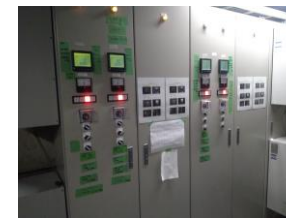
ポンプインバーター盤
