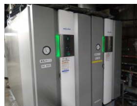
蒸気ボイラ:2台 ボイラ効率：97% 相当蒸発量：2t/h
