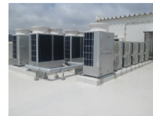
冷却設備室外機
