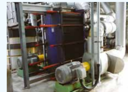
4. 空調系熱交換器 冷却能力 1,350kW (350JRT)
