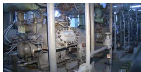
多気筒式冷凍機
