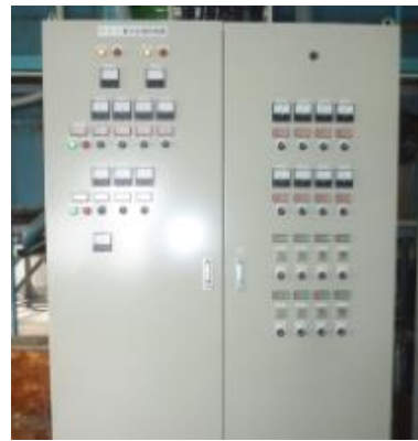
冷凍機制御盤
