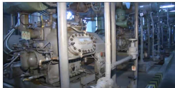
多気筒式冷凍機
