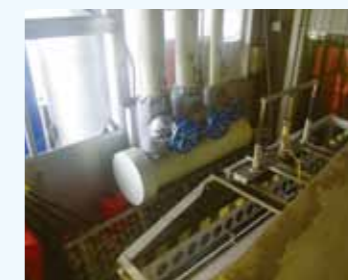
2. 蒸気ヘッダー 設置場所：第一工場
