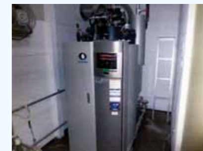
2. 蒸気ボイラ 相当蒸発量 500kg/h、 燃焼効率 95% 薬注装置、給水タンク、軟水装置 含
