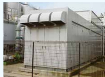
2. 高効率型アンモニア冷凍機 冷却能力 784kW (200JRT)
