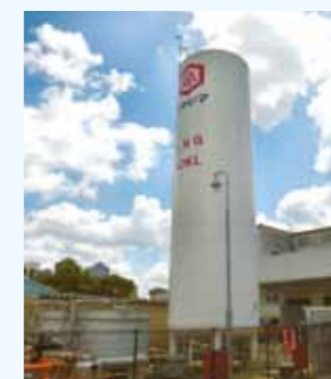
5. LNGサテライト設備 (貯槽60kL)
