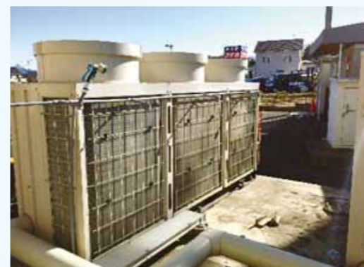
1. インバータ式冷凍機 冷凍能力 250.21kW
