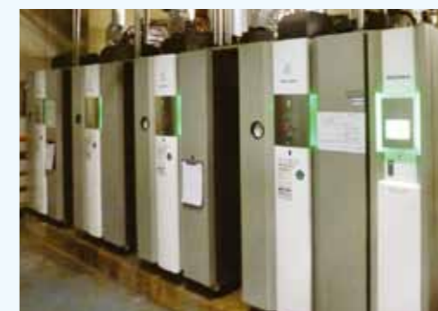
2. LNG高効率ボイラ 2t/h, 1.5t/h、ボイラ効率98%
