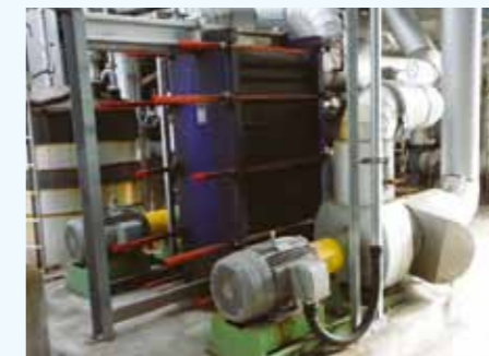
4. 空調系熱交換器 冷却能力 1,350kW (350JRT)
