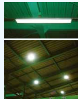
3. LED照明 16.9W、20.7W 高天井用LED115W他
