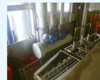
2. 蒸気ヘッダー 設置場所：第一工場
