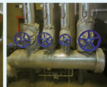
2. 蒸気ヘッダー 設置場所：ボイラ室
